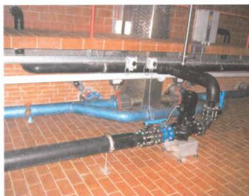
Transportpumpe ved filtersektion 3
